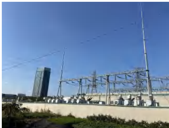
图 2-3 镜湖 220kV 变电站间隔扩建侧现场照片
