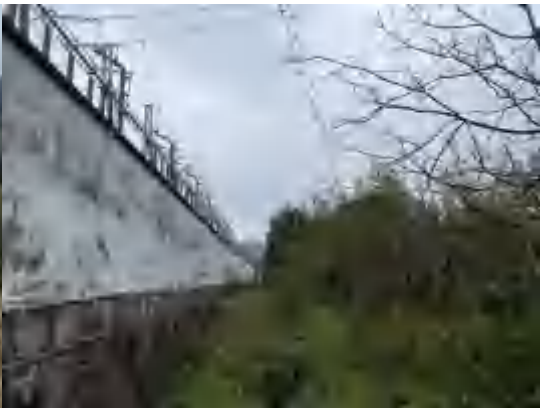
牌头变间隔侧现状
